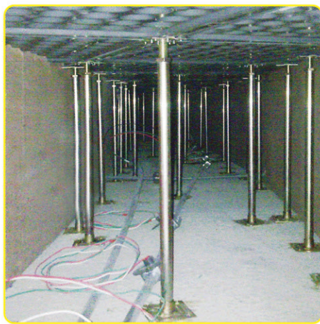
高架地板底部實景
